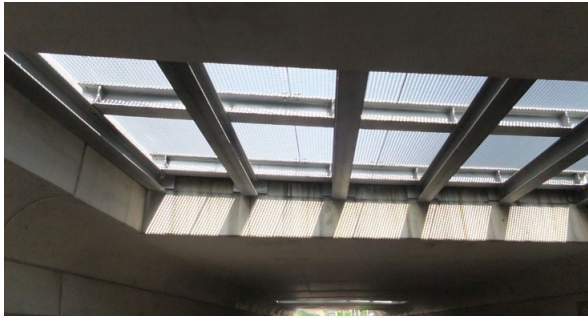
Tageslichtöffnungen im Deckenbereich machen Unterführungen heller und damit angenehmer.
